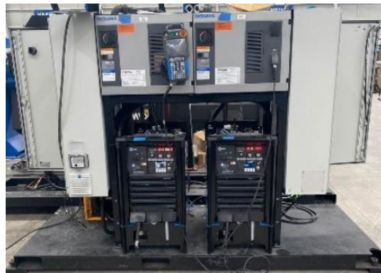
Figura 33. Pedestal de controles.
